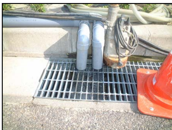
⑨排水状況
